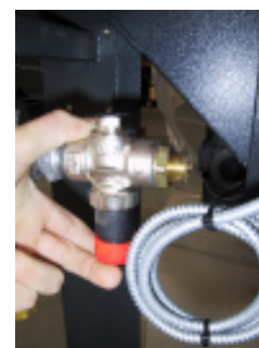
Sprinklerventil med afmonteret slange
