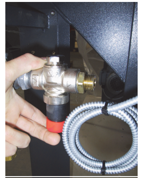
Sprinklerventil med afmonteret slange
